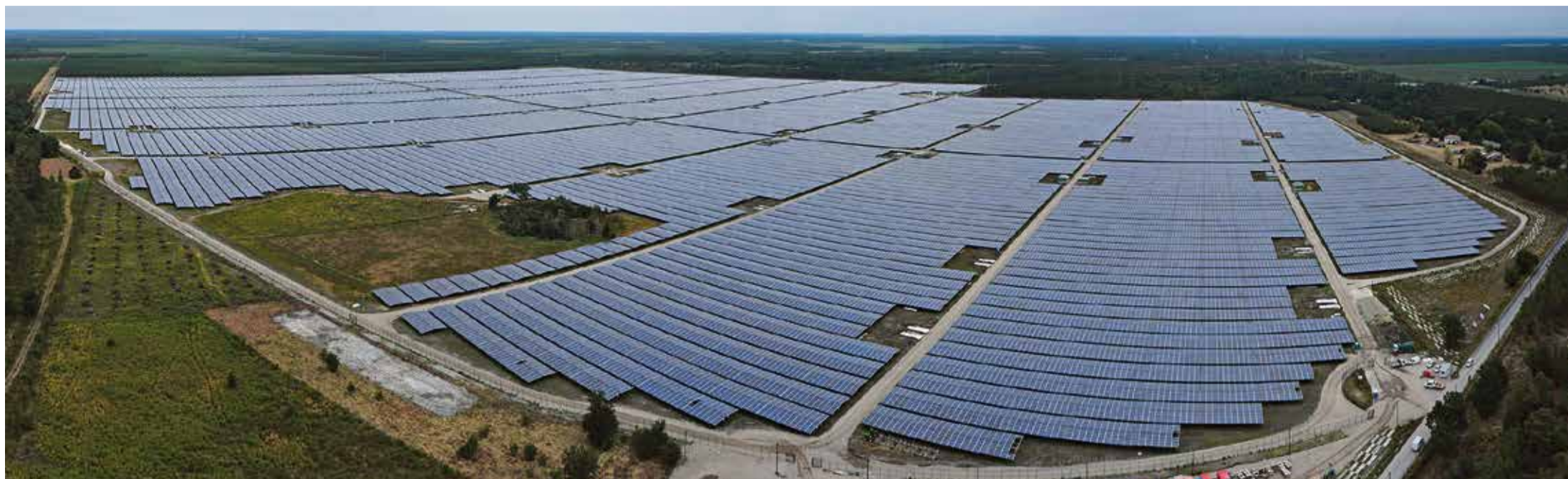
Le parc photovoltaïque de Cestas, près de Bordeaux, s'étend sur 260 hectares où sont assemblés près d'un million de panneaux solaires. C'est la plus grande installation européenne de ce type (300 MW de puissance), et la troisième du monde. (LDD)
